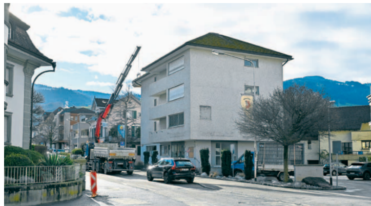
Am Montag hat der Abbruch der 60-jährigen Liegenschaft begonnen. Die Strasse sollte während der Bauzeit dank des «Aufbockens» des Krans stets passierbar bleiben.
